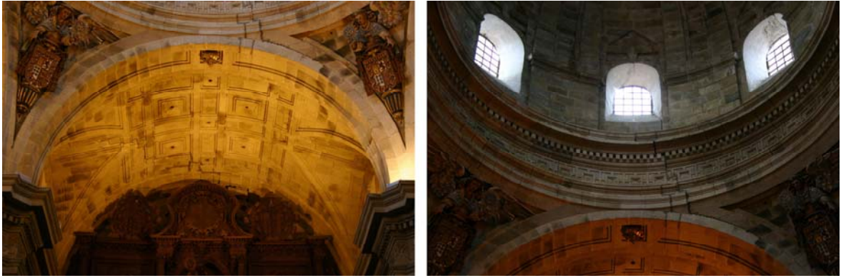
Figura 21. Esquerda , movementos na bóveda do presbiterio. Sobre o retablo unha doela descolgada. Dereita , gretas na cornixa da cúpula.
