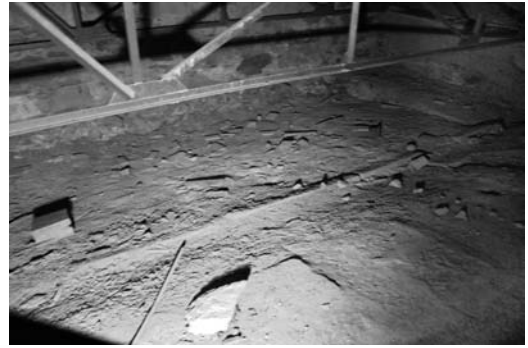
Figura 8 Extradós de la bóveda. Se aprecia una hilada longitudinal que sobresale radialmente en el límite entre la zona central y la de las lunetas
