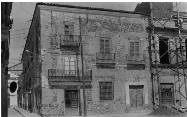
FIGURA 6 Casa de la esquina de la Plaza del ayuntamiento con la calle Feria en proceso de intervención. AGA
